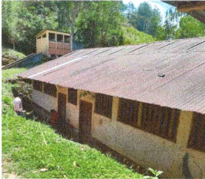
Foto 1: Vista exterior de cubierta de techo de aulas que necesita ser cambiada ya que la actual se encuentra en mal estado.
