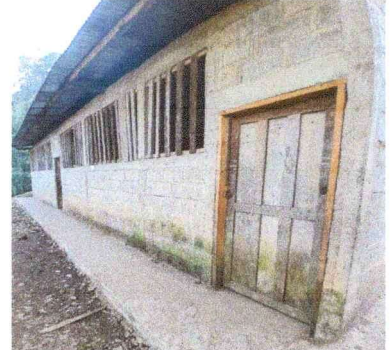
Foto 2: Vista lateral de aulas en donde se puede notar la necesidad de cambio de ventanas y puertas.
