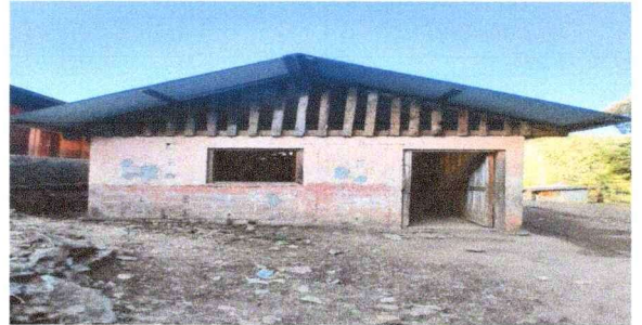
Foto 4: Vista de establecimiento con necesidad de aplicación de pintura.
